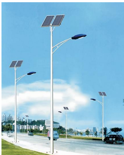
Ryc. 22 System oświetlenia ulicznego wykonanego z opraw LED zasilanych energią elektryczną z paneli fotowoltaicznych źródło ELGO Gostynin
