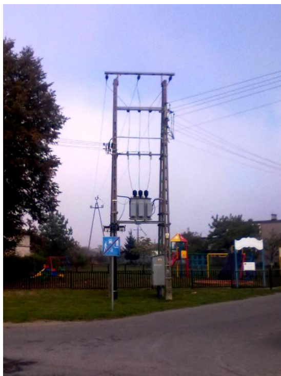
Ryc. 6 Stacja transformatorowa STS 20/250 w m. Waganiec - widoczne elementy
