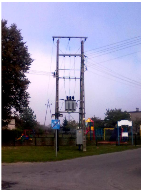
Ryc. 10 Stacja energetyczna STSa 20 / 250 na żerdziach żelbetowych pamiętająca czasy II elektryfikacji kraju po częściowej modernizacji
