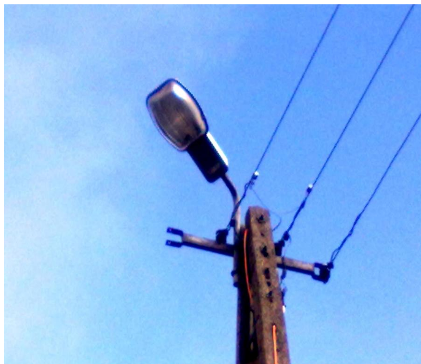
Ryc. 8 Fragment linii energetycznej nn z oprawą sodową energochłonną i niedostosowaną do aktualnych potrzeb oświetlenia z XXw
