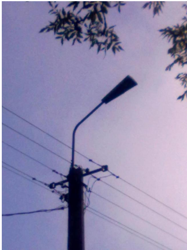
Ryc. 7 Fragment linii energetycznej nn z oprawą oświetlenia produkowaną w latach 70 – 80-tych XXw
